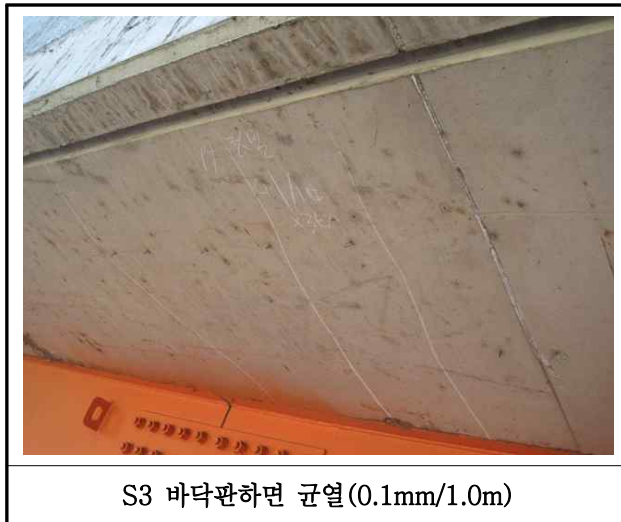
【사진 23.3.3】 바닥판하면 손상현황
