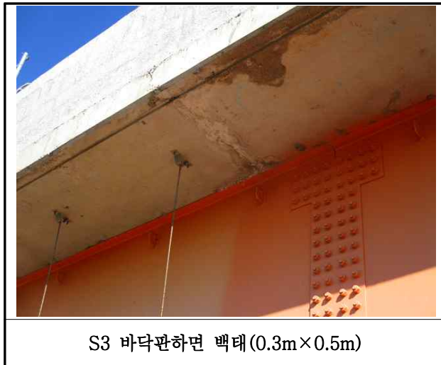
【사진 23.3.26】 바닥판하면 손상현황
