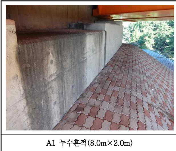
【사진 23.3.32】 교대 손상현황
